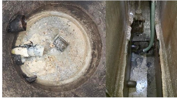
Fett in Kanal und Pumpstationen
